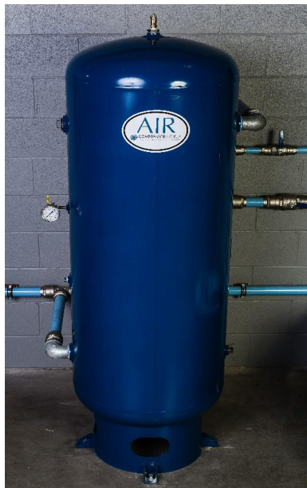
Figura 3: Reservatório de ar comprimido suportado por saia [13].
